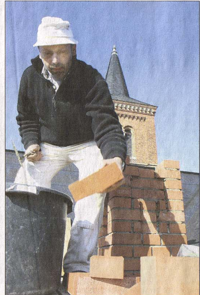
Die Prenzlauer Denkmalpflege GmbH erneuert in Vichel derzeit die Schornsteine der Kirche. Fotos (2): Kluge
